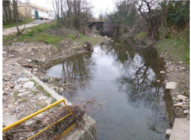
Zone importante de dépôt de limon en amont du passage busé de l'Avène dans la traversée de Salindres
