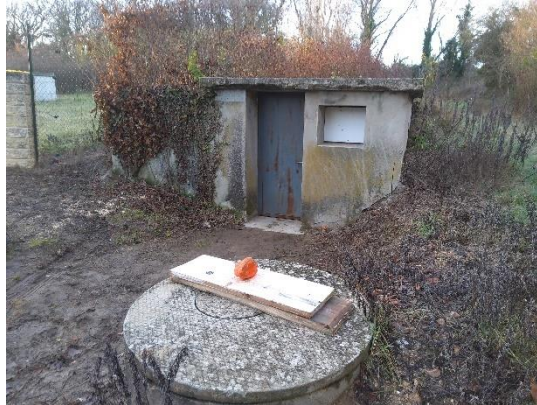
Figure 13 : Bâti béton de la source de Barbion recueillant les eaux de deux galeries drainantes
